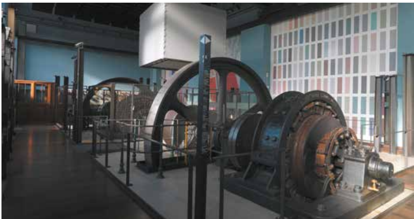
La salle des machines, manufacture des papiers peints à Saint-Fargeau-Ponthierry (Seine-et-Marne)
